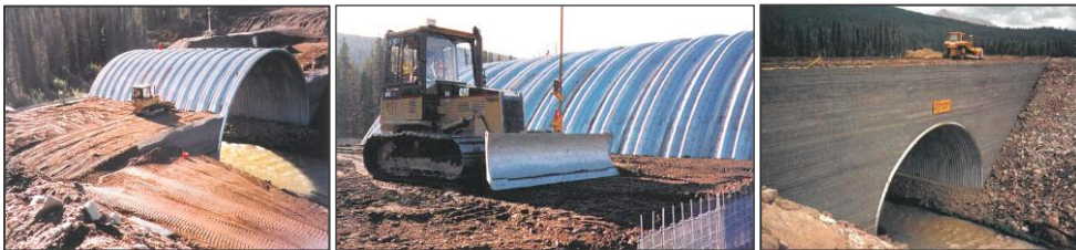
Omfylling med lokal (stedlig) naturlig avsatt sand og grus. Kemess Creek, Canada (1997).
